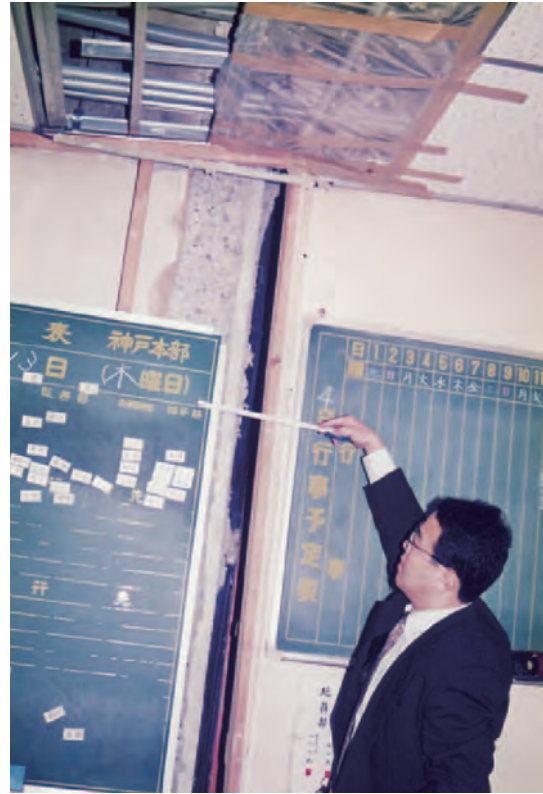
▲県立水産会館の被害
