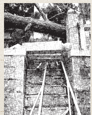
▲漁友鎮魂の塔が台風被害
