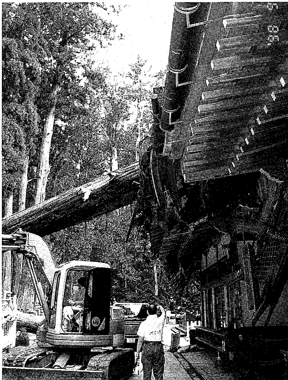
倒木により大きく損壊
